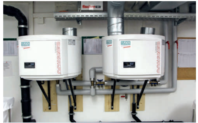
Wärmerückgewinnung: Warmwasseraufbereitung und Klimaanlage in einem.
